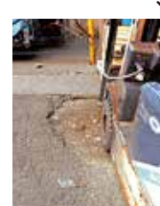
築地市場内のアスファルトの亀裂
